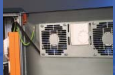
Stromverteilung und Lüftung
